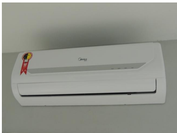
Ar Condicionado guarita
